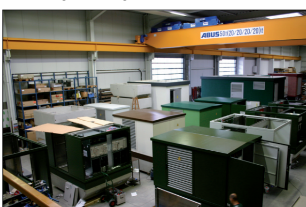
Montagehalle für Trafostationen mit 50-Tonnen-Kranbahn.
