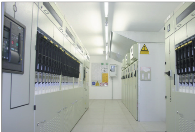
Innenansicht einer Trafostation.
