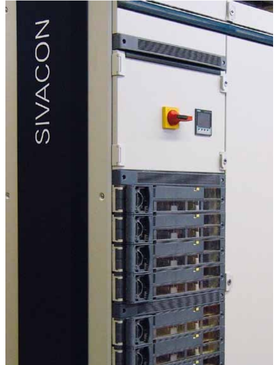
Die kompakte Bauweise sorgt für einen flexiblen, wirtschaftlichen Aufbau der SIVACON S8.
