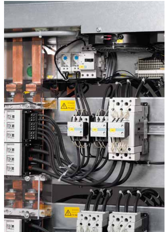
Die Kondensator-Baugruppen sind verdrosselt oder unverdrosselt einsetzbar.
